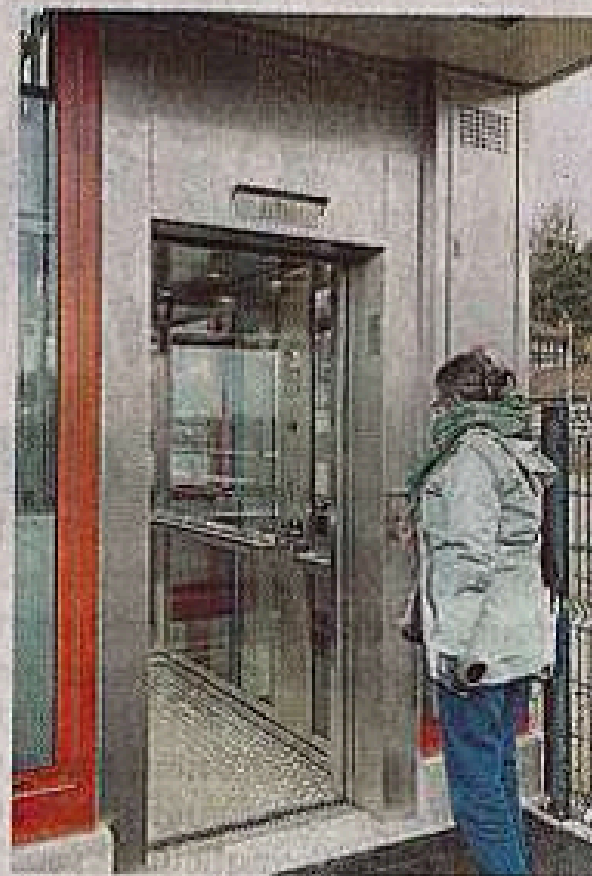
La gare est équipée d'un ascenseur.
