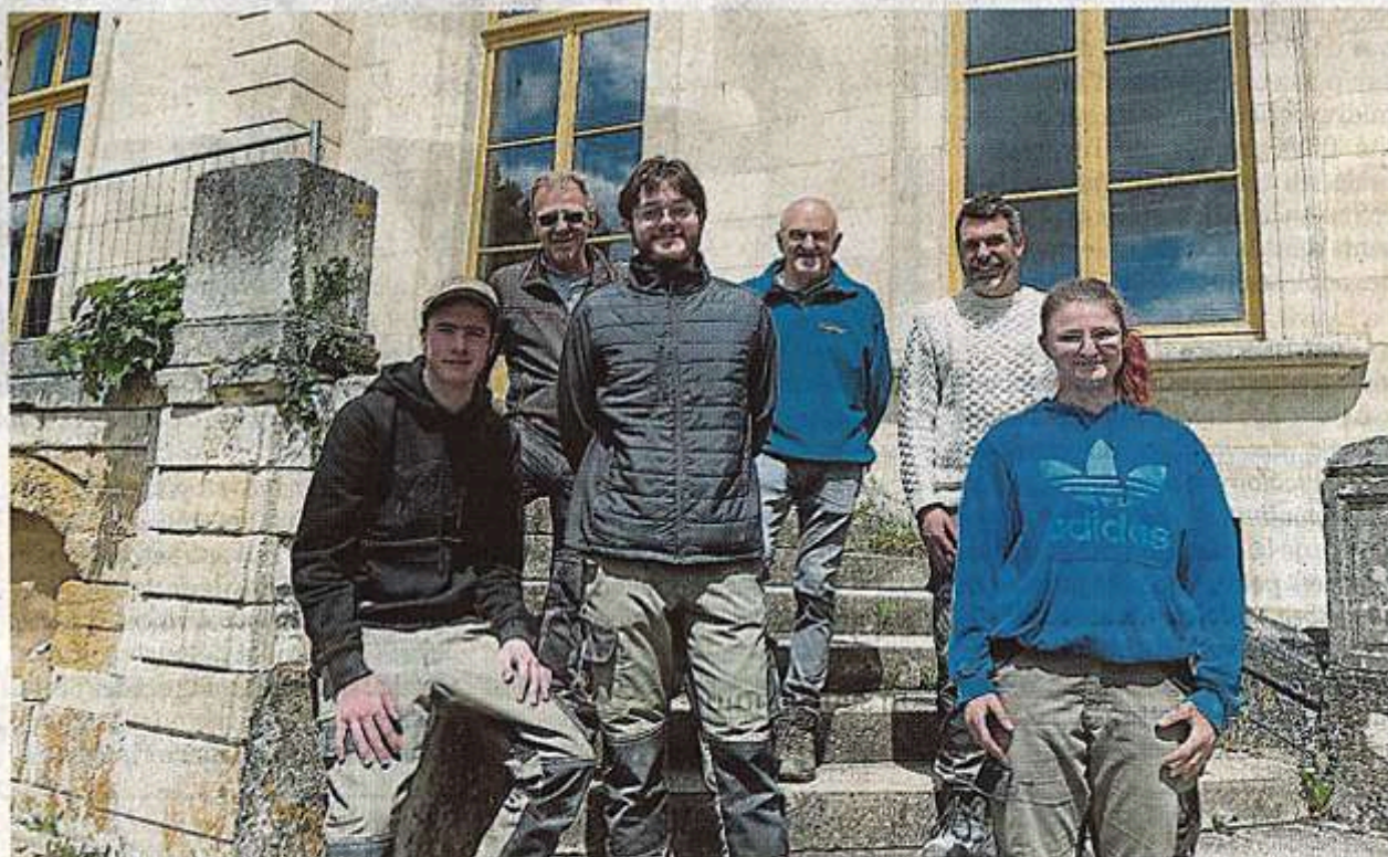
Cherré-Au, mardi 12 mai 2026. Au château du Haut-Buisson, trois apprentis maçons en bâti ancien ont la lourde tâche de refaire les perrons et les escaliers.
